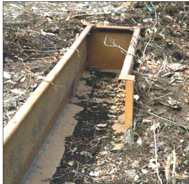
Fig. 4. Ende av ledeanordning, Tyskland. Den U-formete avslutningen tvinger amfibier som går feil veg til å snu. (Foto: S. Zumbach). Kilde: Vegetasjon og dyreliv . (Iuell (red.) 2005).
