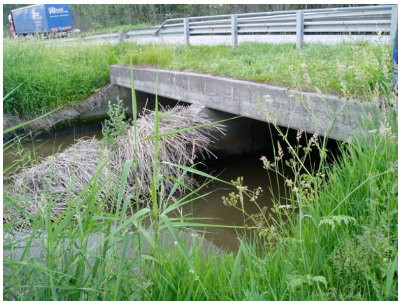
Fig. 2. Eksisterende kulvert fotografert fra nordvest den 30. juni 2003. Vannstanden var på dette tidspunktet tilnærmet normal. Foto: Ola Wergeland Krog.
