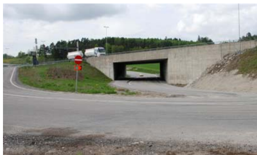
Fig. 8. Kulverten ved Børstad vest for Stikkaåsen er ikke egnet som faunapassasje. Foto: Ola Wergeland Krog.
